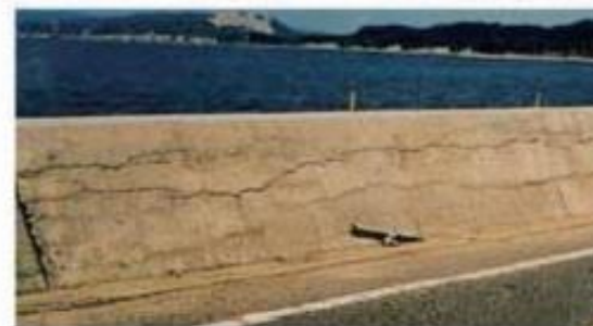
Các ví dụ vết nứt do phản ứng cốt liệu kiềm
