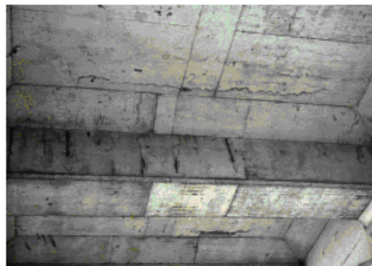
Nứt do cacbonát hóa gây xâm thực cốt thép (mặt dưới kết cấu tòa nhà)
