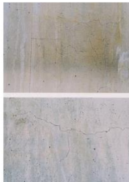
Các nứt nhỏ trên bề mặt bê tông do co
