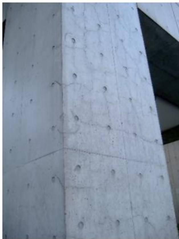
Nứt tự co trong cột bê tông cường độ cao
